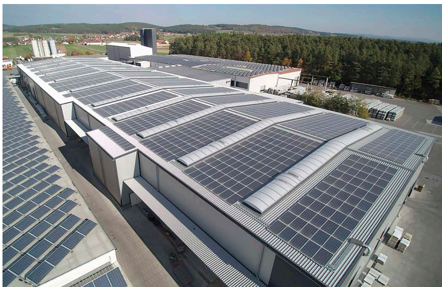
Střechy výrobních hal v Höglu pokryté fotovoltaickými panely
